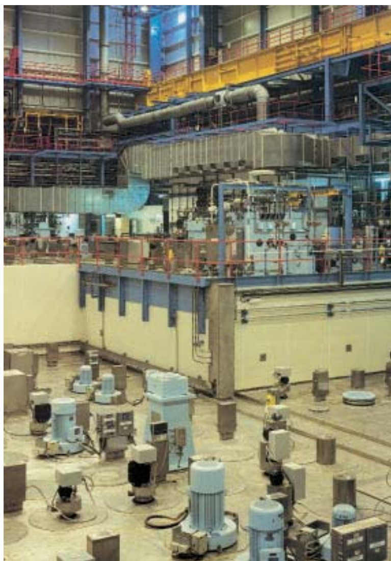
Enhanced Actinide Removal Plant (EARP) est l'un des cinq ateliers de traitement des effluents conçus pour réduire au maximum la quantité de rejets dans la mer d'Irlande.
