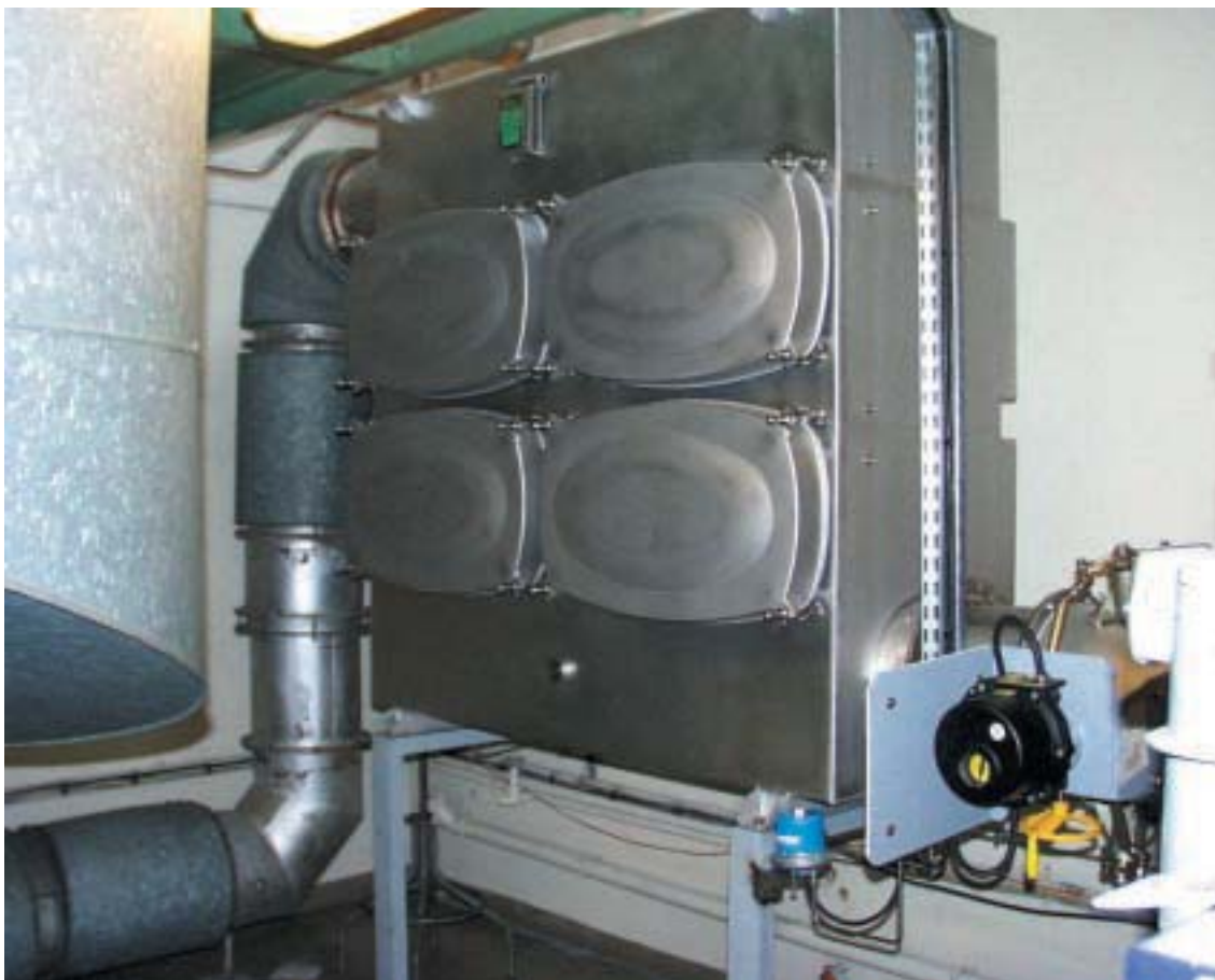
Doublement du dispositif de filtration d'un équipement d'INB pour réduire l'activité des rejets gazeux
