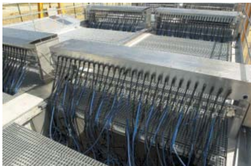
Station de traitement par UV des rejets de la centrale de Civaux (prévention des amibes)
